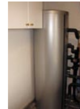
Opslagvat van de zonneboiler.
