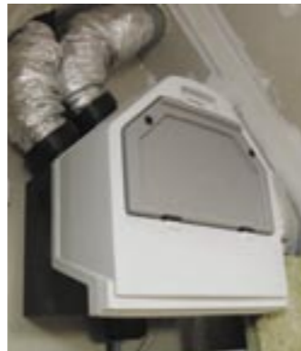
Warmtebalanstoestel recupereert de warmte van de afgevoerde vervuilde lucht.
